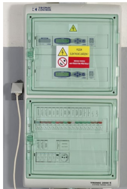
Zabezpečení kotleny podle legislativy podléhají kotleny nad 100 kW výkonu.
