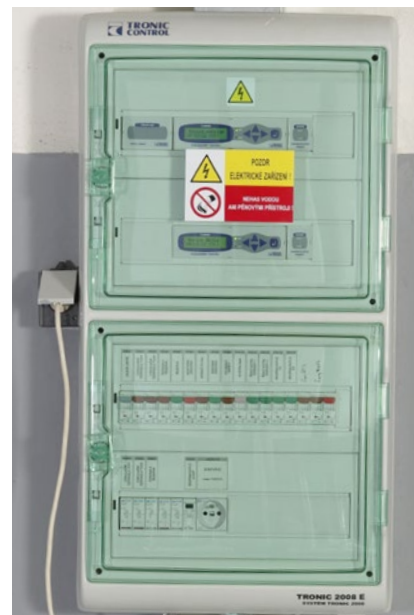
Zabezpečení kotelny podle legislativy podléhají kotelny nad 100 kW výkonu.
